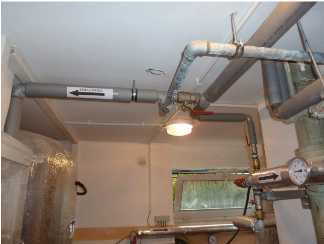
Pomieszczenie (węzeł) instalacji solarnej
