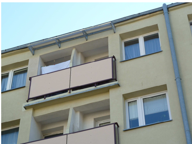
Daszek nad balkonem ostatniej kondygnacji i przęsła balkonu
