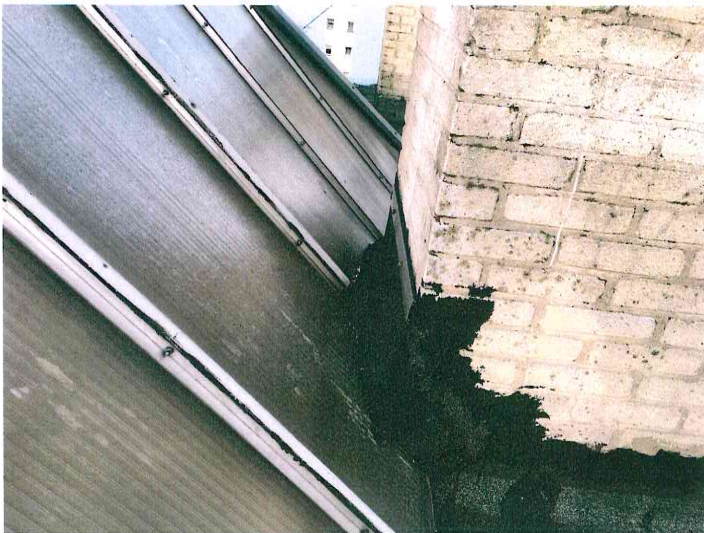
Rys. poglądowy nr 9 – „odbój” na punktowcu z naświetlem przed remontem
